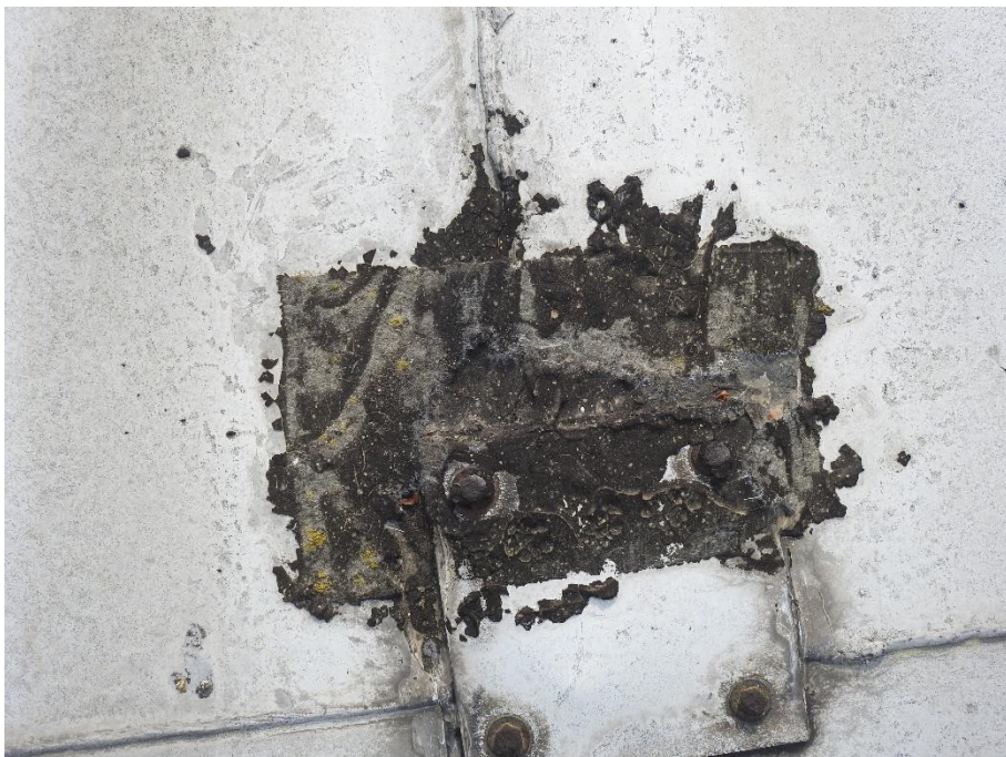
Slika 22: Prikaz neuspešnega dodatno izvedenega tesnjenja pločevinaste strehe
