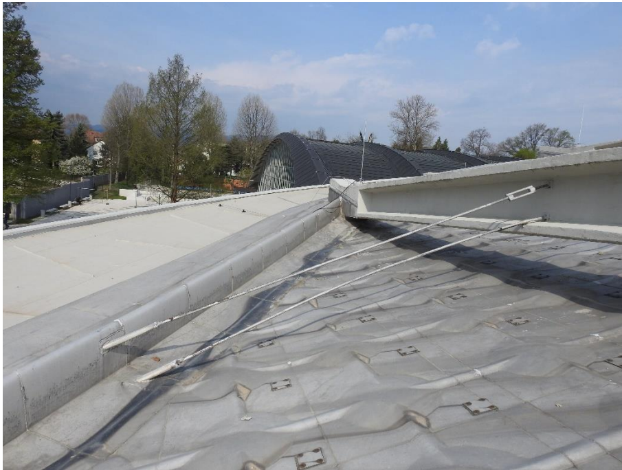
Slika 11: Prikaz pogleda na zatego, kjer smo evidentirali odpiranje stika med zatego in pločevinasto kritino strehe
