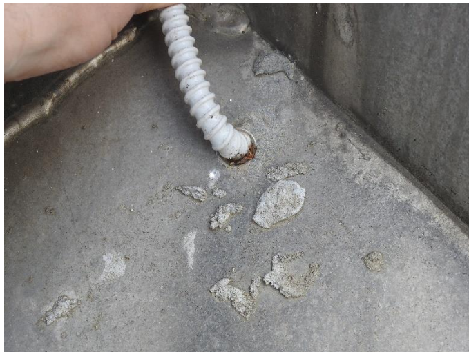
Slika 9: Prikaz izvedbe preboja pločevinaste strehe elektro instalacije, ki ne zagotavlja vodotesnosti
