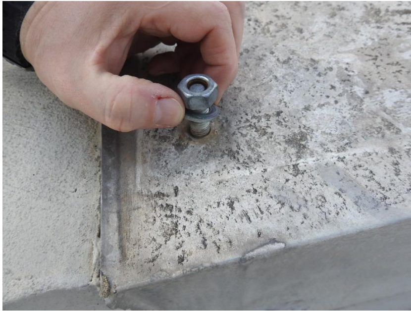
Slika 25: Prikaz pogleda na sidrni vijak, ki ne zagotavlja vodotesnosti
