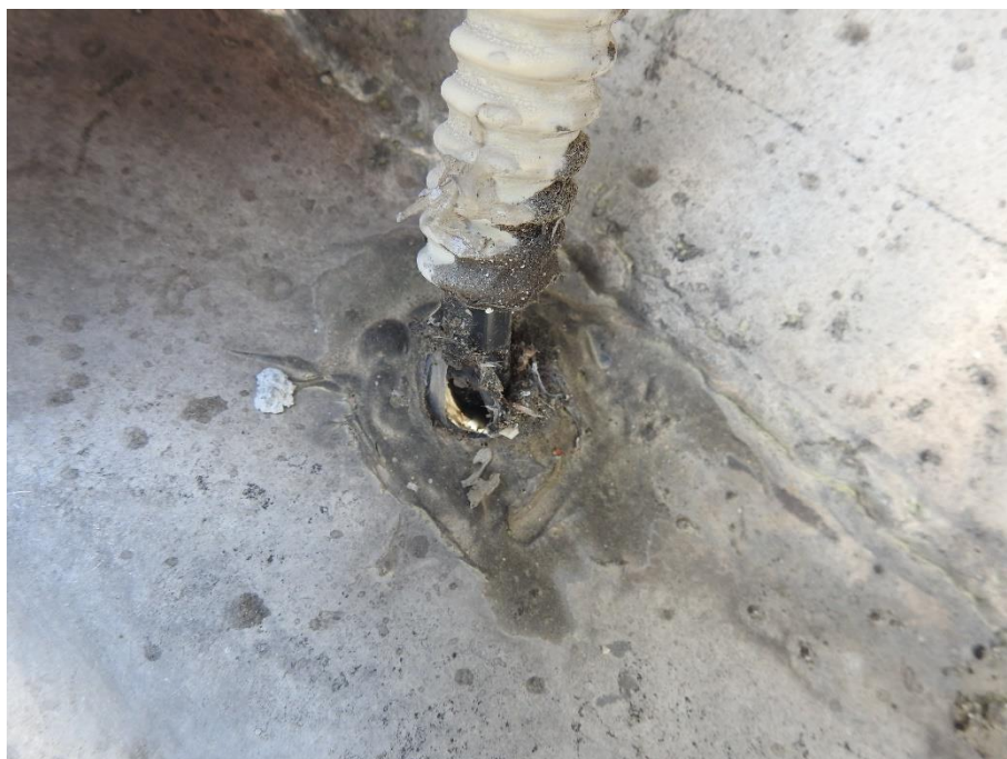
Slika 7: Prikaz izvedbe preboja pločevinaste strehe elektro instalacije, ki ne zagotavlja vodotesnosti
