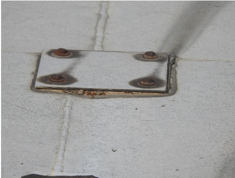
Slika 27: Prikaz pogleda na netesen stik med kritino in sidrno ploščico (zgornja stran strehe), vključno z rjavenjem sidrnih vijakov in netesnosti prebojev sidrnih vijakov
