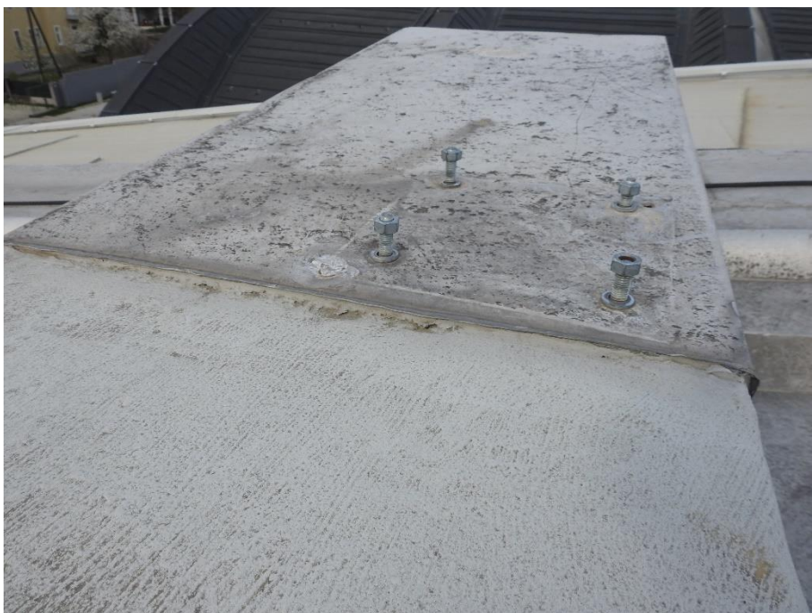
Slika 24: Prikaz pogleda na sidrne vijake konstrukcije, ki je bila v preteklosti že odstranjena
