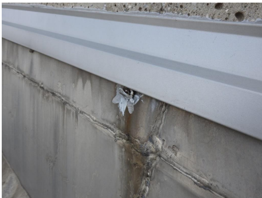
Slika 5: Prikaz netesnega preboja na vertikalni površini pločevinaste obloge strehe, ki je vgrajena na zahodno – vertikalno površino glavnega loka tribune
