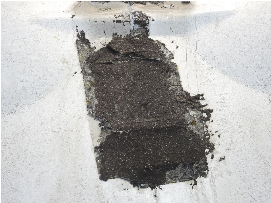
Slika 21: Prikaz neuspešnega dodatno izvedenega tesnjenja pločevinaste strehe
