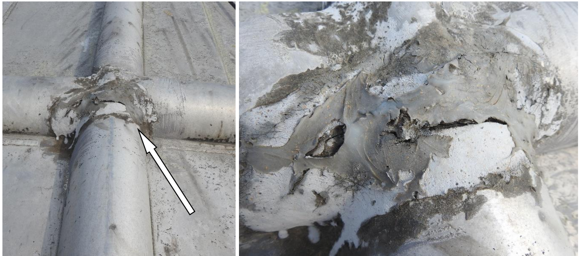
Slika 15: Prikaz neuspešnega dodatno izvedenega tesnjenja pločevinaste strehe
