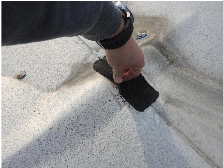
Slika 17: Prikaz neuspešnega dodatno izvedenega tesnjenja pločevinaste strehe
