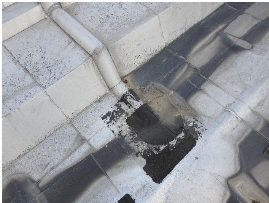
Slika 18: Prikaz neuspešnega dodatno izvedenega tesnjenja pločevinaste strehe
