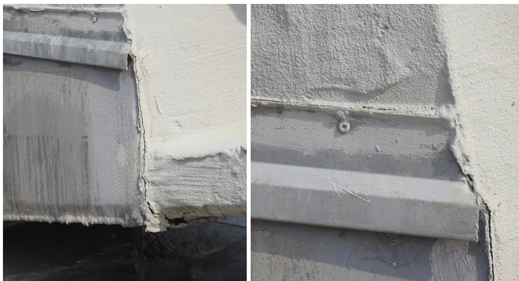
Slika 14: Prikaz odpiranja stika med a.b. nosilcem in pločevinasto kritino strehe ter med a.b. nosilcem in novejšo odkapno pločevino
