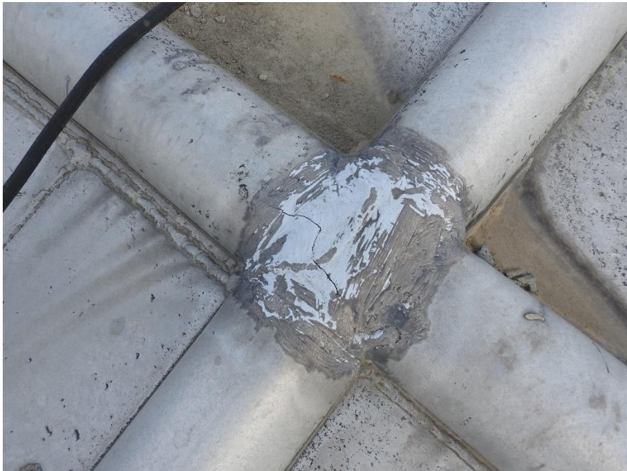
Slika 19: Prikaz neuspešnega dodatno izvedenega tesnjenja pločevinaste strehe
