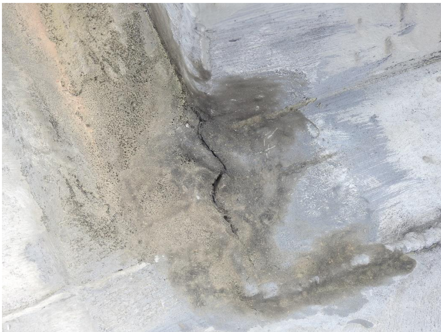
Slika 20: Prikaz neuspešnega dodatno izvedenega tesnjenja pločevinaste strehe
