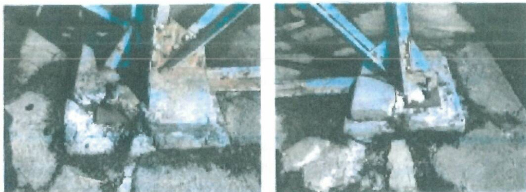
Slika 6: Poškodbe na spodnjem delu stolpa, Vir Poročilo IMK o stanju konstrukcije
