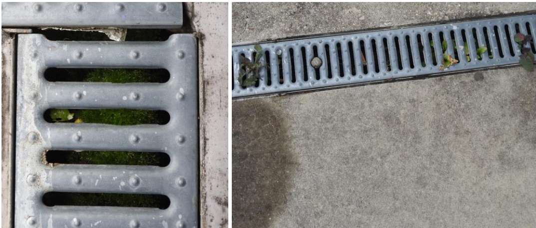
Slika 7: Prikaz pogleda na »zelenje« v notranjosti kanalet za odvod površinske meteorne vode
