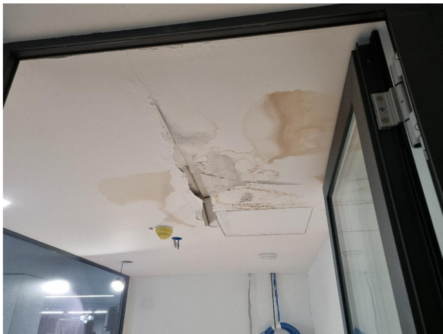
Slika 3: Prikaz sledi in poškodb obloge spuščenega stropa v prostoru 3.1 - prevajalci, ki se nahaja na severni strani objekta (proti vzhodu)
