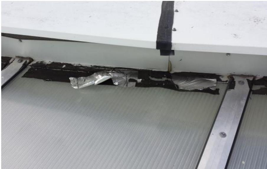
Slika 38: Prikaz pogleda na stanje butilnega traku, ki ne zagotavlja vodotesnosti stika
