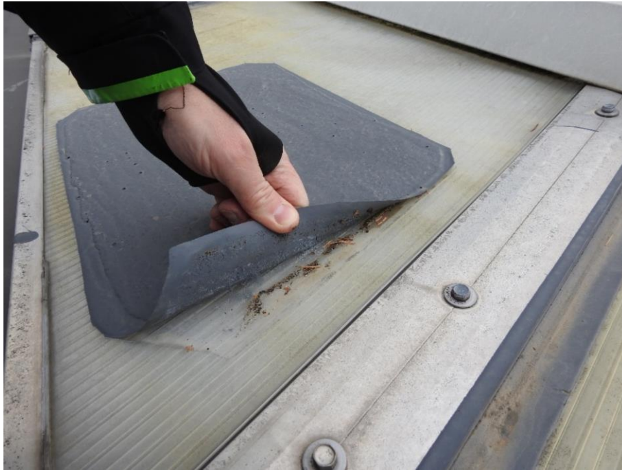
Slika 22: Prikaz odstopanja dodatno izdelane preplastitve – tekoča membrana
