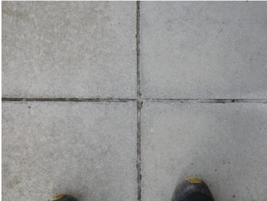
Slika 12: Prikaz odstopanja tesnilne mase v navidezni dilataciji betona pohodne plošče
