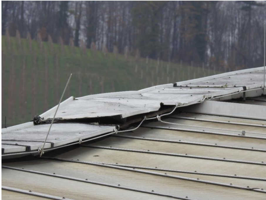
Slika 30: Prikaz mehanske poškodbe pločevinaste obrobe ob zunanjem robu transparentne strehe – predel nad vzhodno tribuno (ob JV vogalu)
