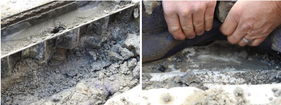
Slika 47: Prikaz zastajanja vode v predelu zgornjega dela in spodnjega dela cevi za odvod meteorne vode
