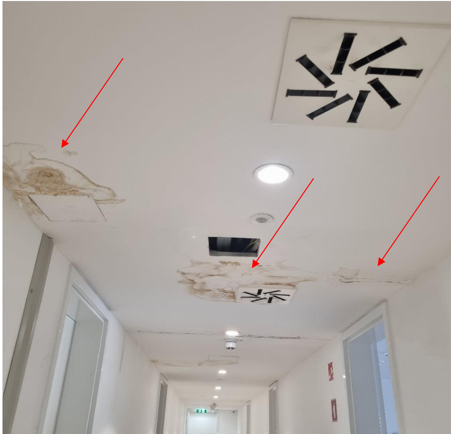
Slika 2: Prikaz sledi in poškodb obloge spuščenega stropa v predelu ob prostoru 10 – sejna soba, ki se nahaja na severni strani objekta (proti zahodu)
