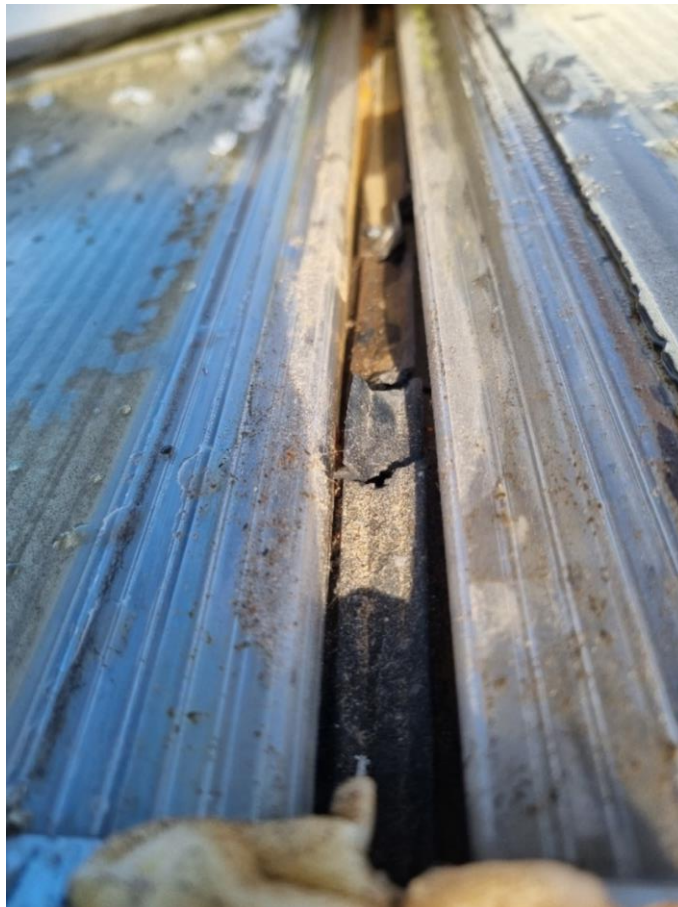
Slika 43: Prikaz pogleda na stanje gumiranega tesnila pod zaključnim alu profilom
