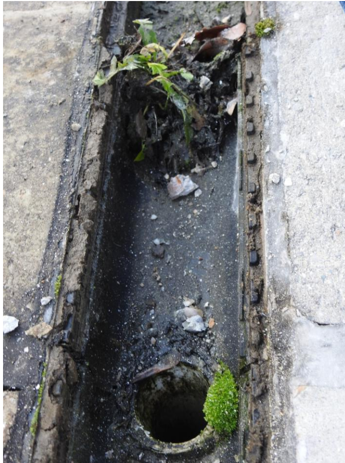
Slika 8: Prikaz pogleda na stanje notranjosti kanalete, v predelu vertikalne odtočne cevi
