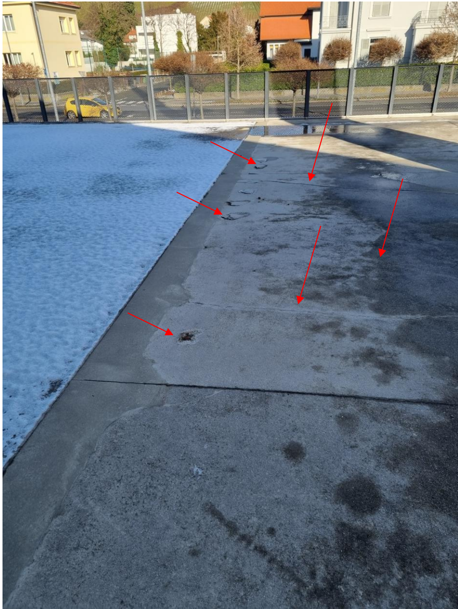
Slika 13: Prikaz razpok in lokalnih poškodb zgornje površine betona pohodne plošče, v predelu SV vogala objekta
