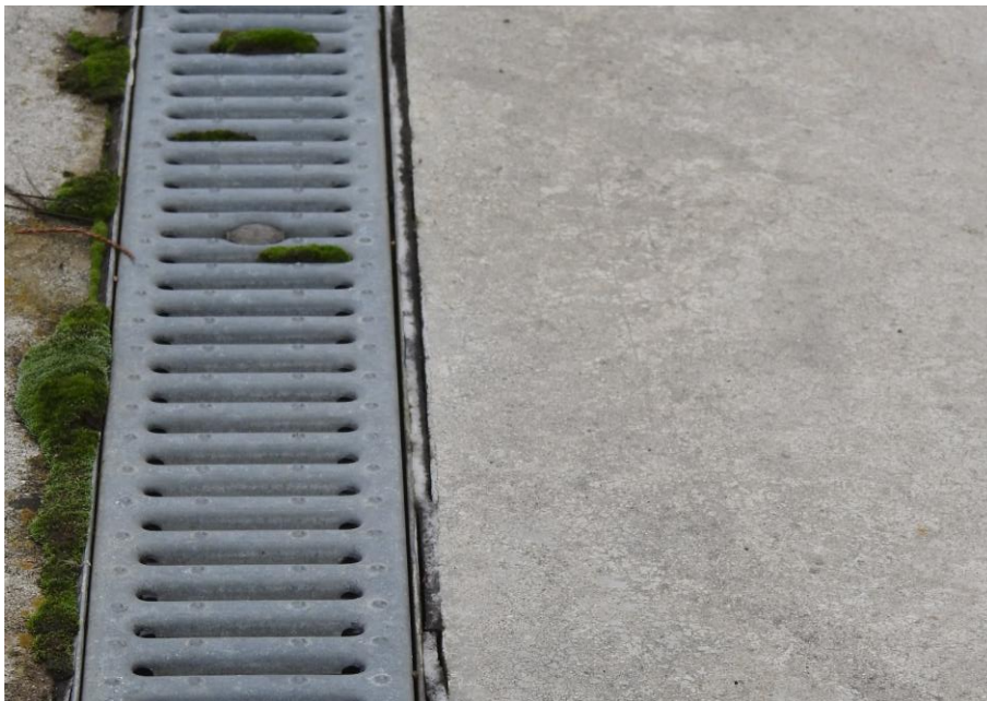
Slika 9: Prikaz zelene poraščenosti v predeli stika beton / kanaleta
