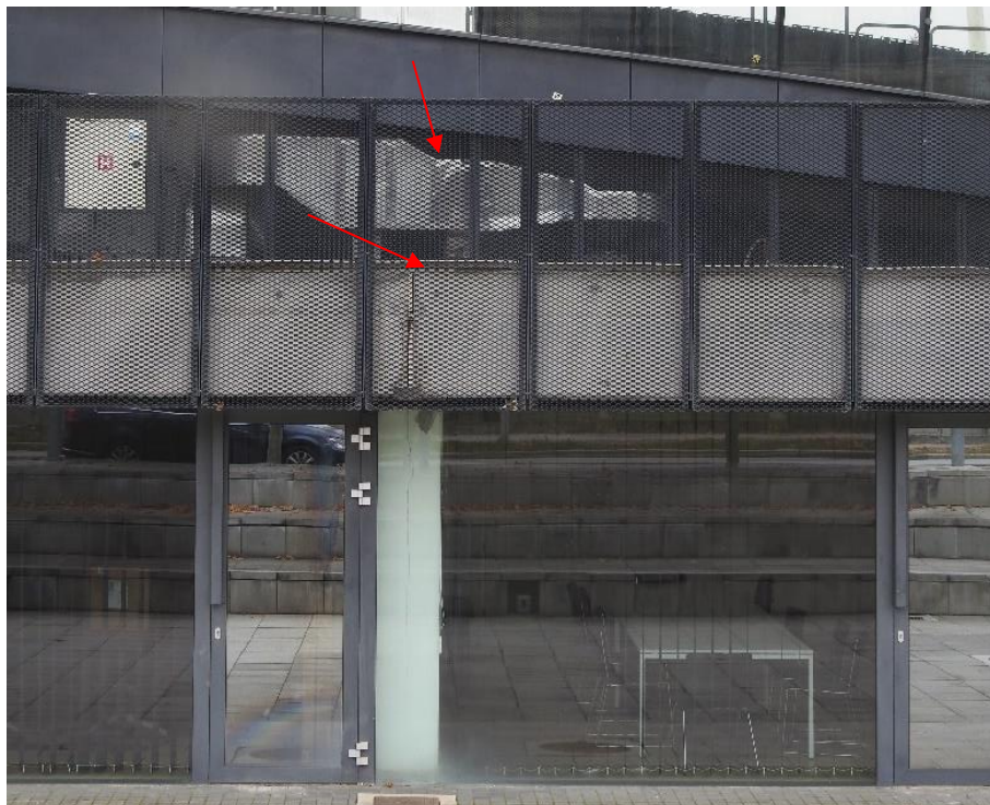
Slika 5: Prikaz sledi precejanja vode skozi prostorsko dilatacijo in nameščenih aklimatov z instalacijami
