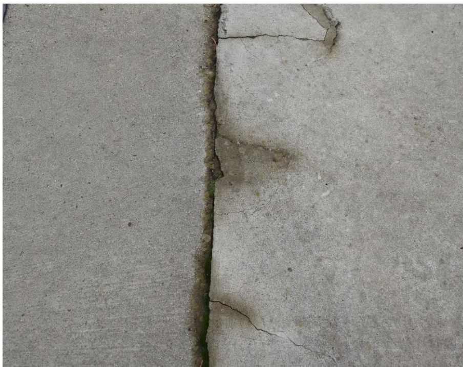
Slika 11: Prikaz lokalne poškodbe betona in razpok ob prostorski dilataciji
