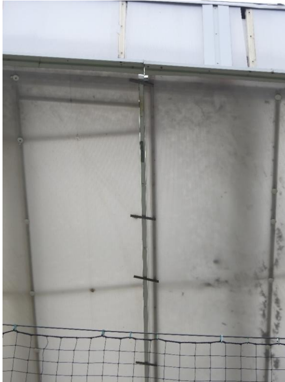
Slika 17: Prikaz odpiranja stika med dvema ploščama v predelu poteka dilatacije, na južni strani objekta
