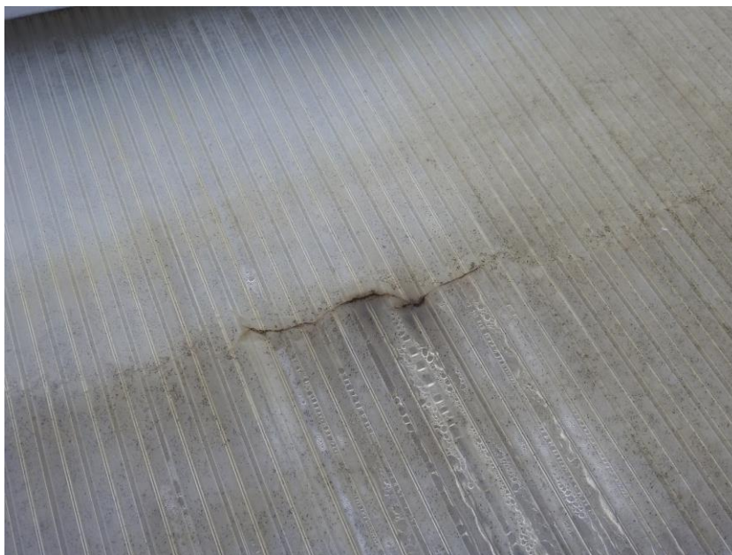
Slika 33: Prikaz pogleda na razpoko v transparentni plošči, v predelu spodnjega roba strehe – nad »Sika« folijo. Takšne poškodbe smo evidentirali na več mestih oz. ploščah, pri čemer se vse te poškodbe nahajajo v spodnjem delu transparentne kritine.
