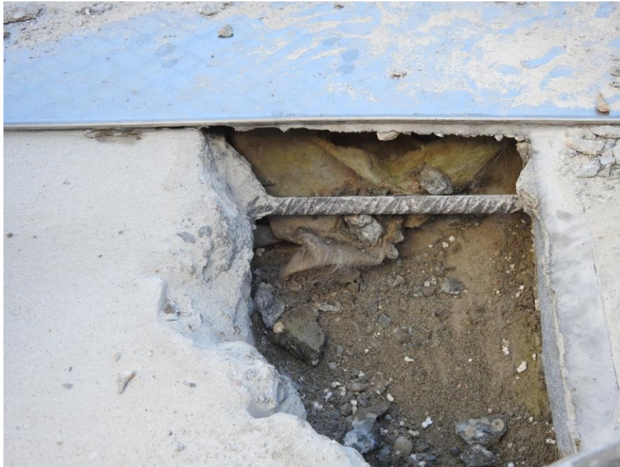
Slika 57: Prikaz pogleda na vlažno površino pod betonom
