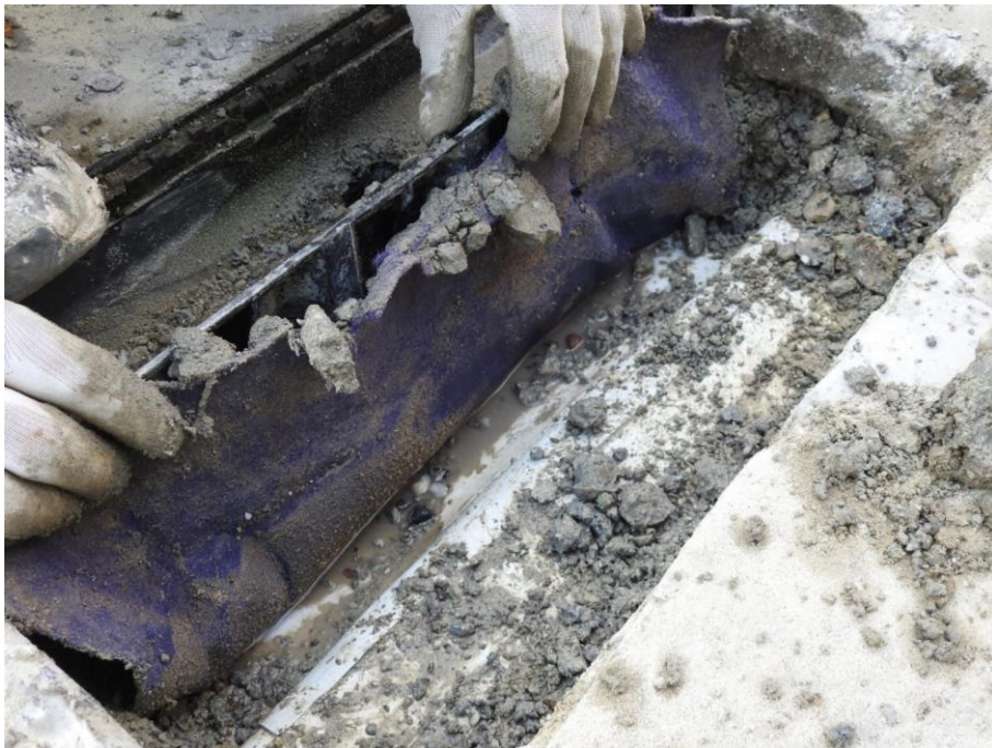
Slika 46: Prikaz pogleda na stoječo vodo v predelu poglobitve, tik ob vertikalni odtočni cevi kanalete
