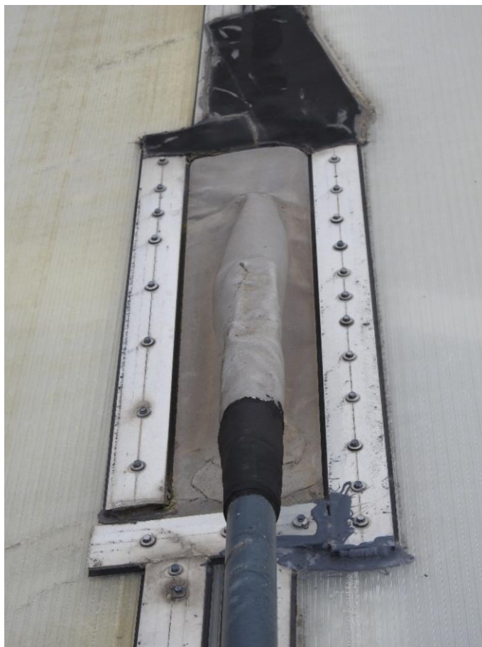
Slika 37: Prikaz stanja v predelu preboja paličja nosilne konstrukcije strehe
