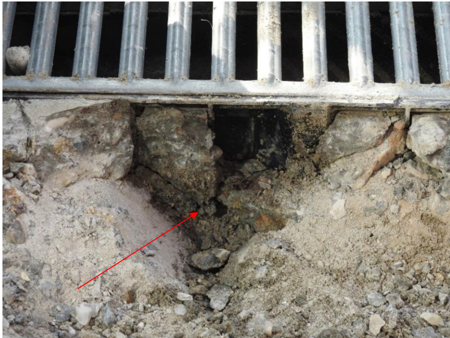
Slika 45: Prikaz pogleda izcejanje vode iz območja kanalete
