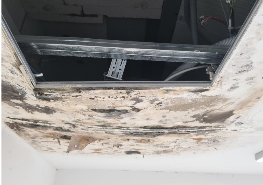
Slika 4: Prikaz sledi in poškodb obloge spuščenega stropa v predelu spuščenega stropa iz gips-kartonskih plošč, ki se nahaja na južni strani objekta
