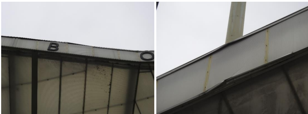
Slika 18: Prikaz povečane prisotnosti umazanije, v predelu mehanske poškodbe pločevinaste obrobe, na vzhodni strani objekta (slika levo) in nad severno tribuno (slika desno)
