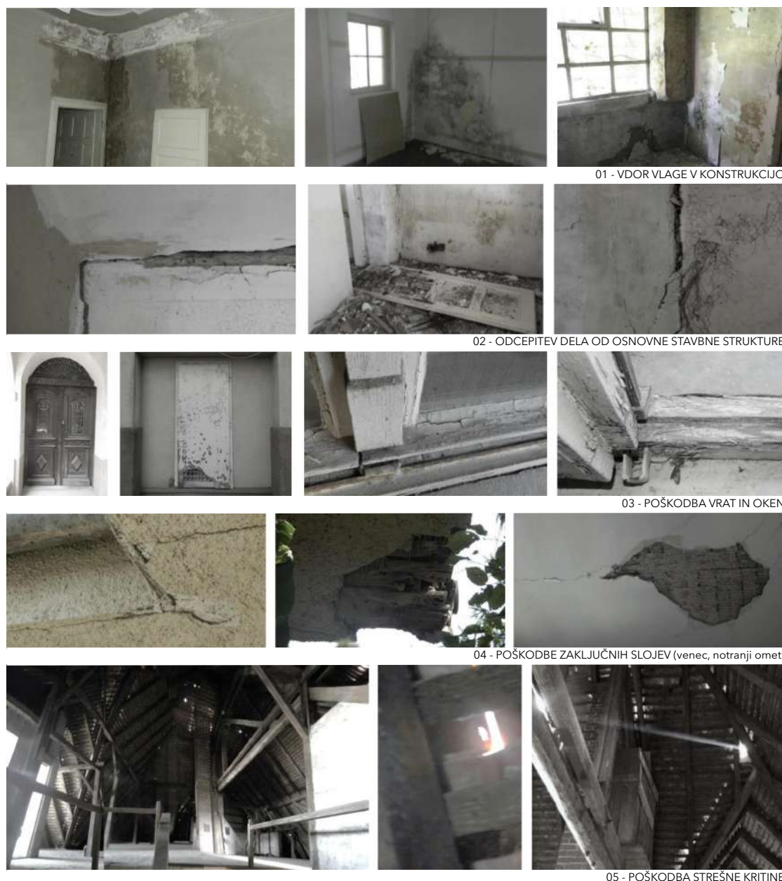
Slika 8: Fotografije poškodb na stavbi (Miha Domjan, 2015)
