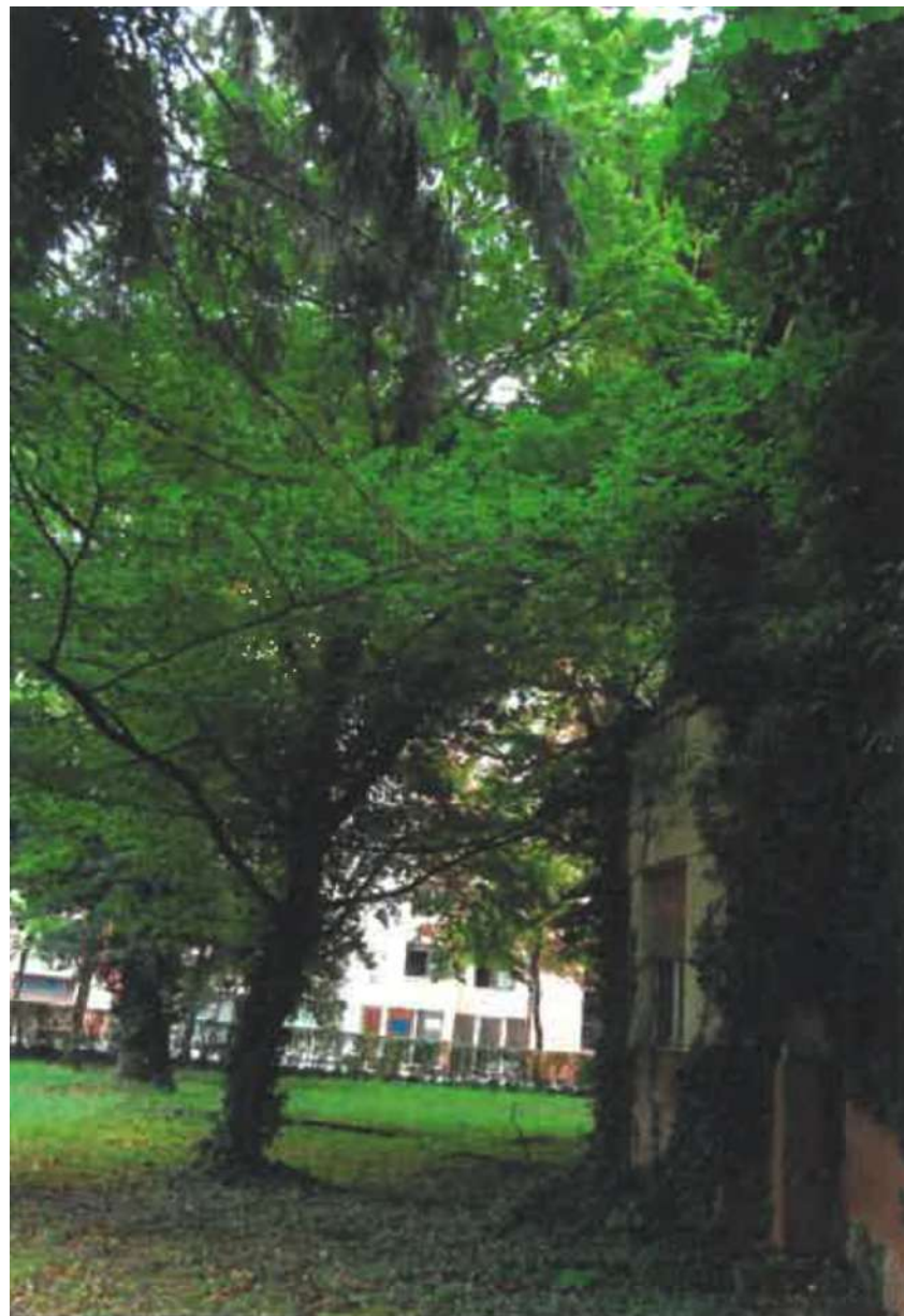
Slika 9: Gaber na vzhodni strani, ki bi ga bilo potrebno odstraniti (Poročilo o ogledu objekta Hartnerjeva vila v Murski soboti, Ježovnik M., 2020)
