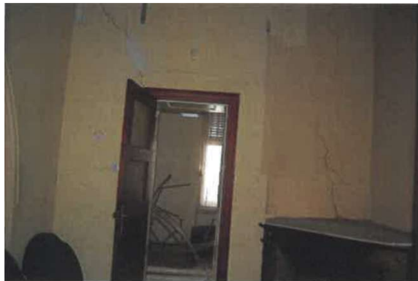
Slika 10: Razpokan zid na stiku podkletenega in nepodkletenega dela (Poročilo o ogledu objekta Hartnerjeva vila v Murski soboti, Ježovnik M., 2020)
