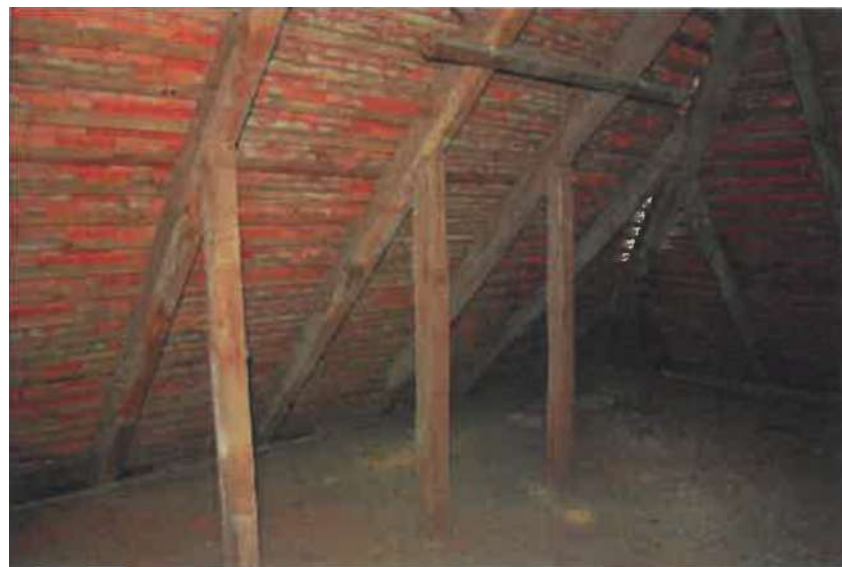
Slika 11: Vidna svetloba na mestu poškodovanega strelovoda in manjkajčih grebenjakov (Poročilo o ogledu objekta Hartnerjeva vila v Murski soboti, Ježovnik M., 2020)
